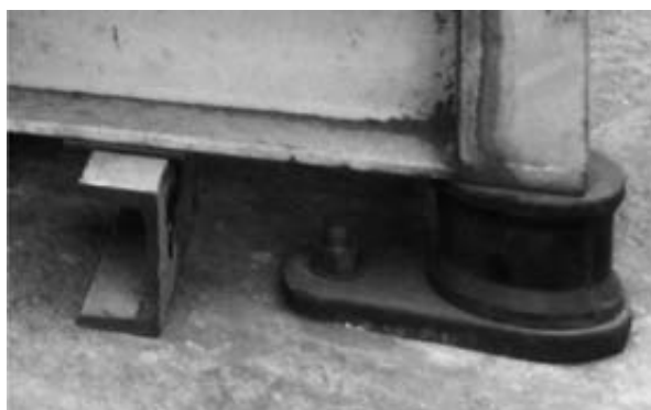
شکل ۸- وجود جسم خارجی در زیر دستگاه
